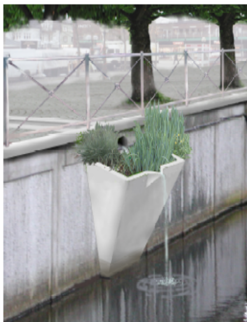
Vegetationsficka med våtmarksväxter som bevattnas med dagvattnet från anläggande ytor. På bilden syns även en ny avskärning till kanalströmmen samt ränna av rostfritt stål.
